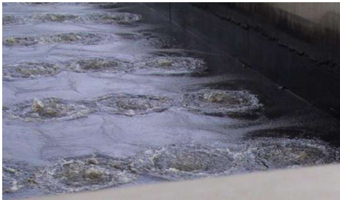
شکل ۶-۱۰ نمایی از سیستم هوادهی در حوضچه متعادل ساز
